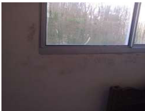
Figura 3. Pontos de infiltração próximos à janela de imóvel do PMCMV.
