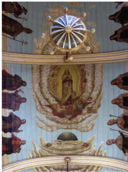
Figura 1: Detalhe da parte central do forro da Igreja da Ordem Terceira do Carmo de São Paulo, com os arcos segmentadores e a imagem da Virgem deslocada, antes do restauro de 2008. Foto: Eduardo Murayama
