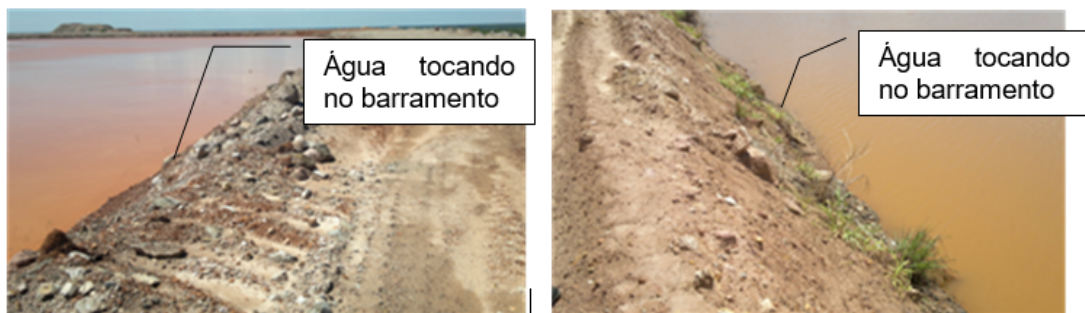
Figura 7 – Água tocando no barramento em condições normais.
