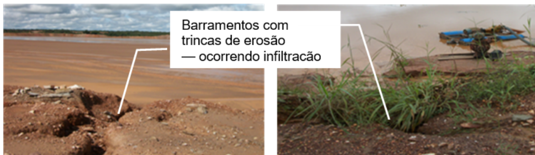
Figura 8 – Água tocando no barramento com problemas.
