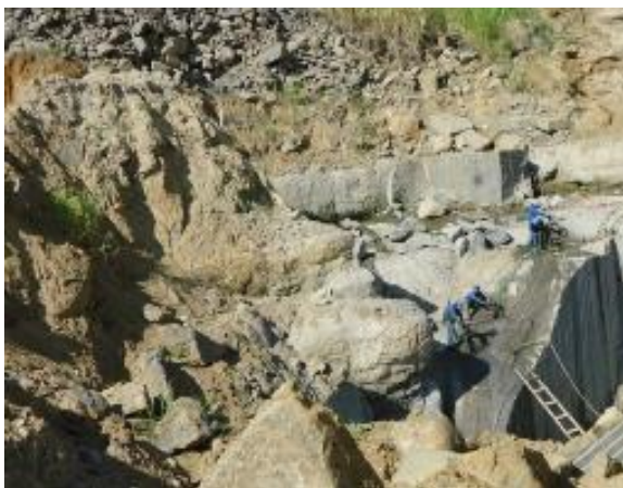
Figura 9: Disposição de estéril sobre matacões possíveis de exploração e colocando em risco os trabalhadores
