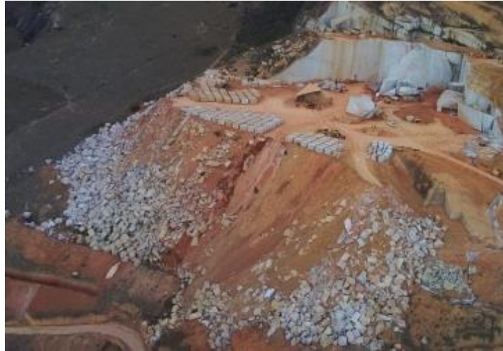
Figura 6: Disposição de estéril em aterro de encosta a jusante da frente de extração
