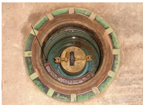
Fonte: Elaborado pelo autor Figura 1. Aterramento/câmara de contenção
