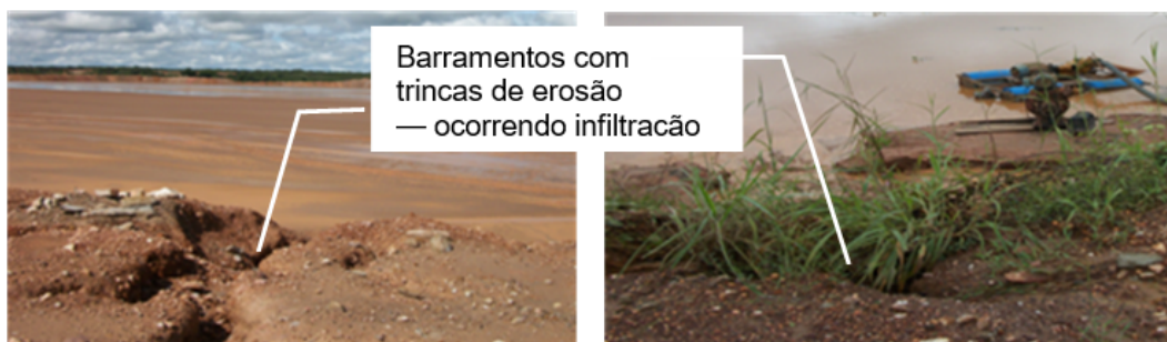
Figura 8 – Água tocando no barramento com problemas.
